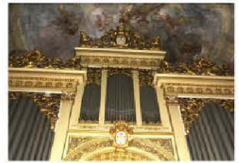
Die stark abgenutzte Orgel in der Piaristenkirche muss dringend saniert werden. Foto: uko
